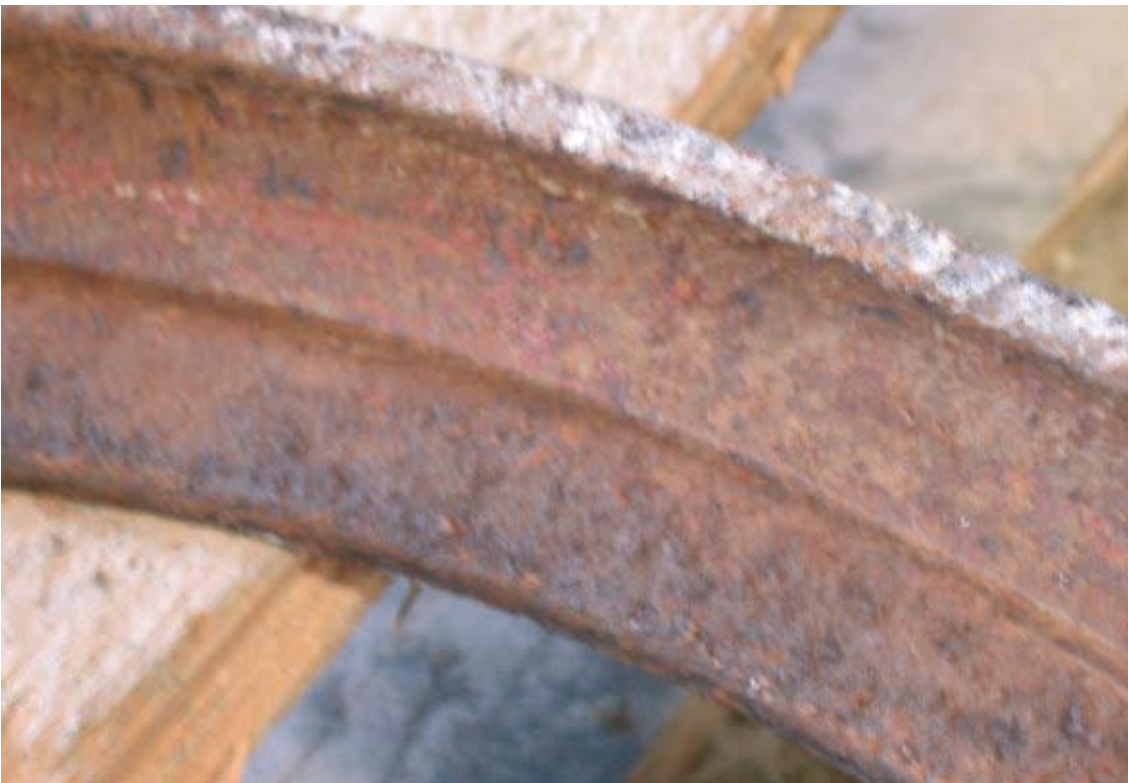
Kuva 2. Vanteen lukkovanneurat ja sisin lukkovanne olivat ruosteessa.
